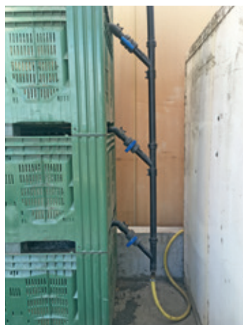
Das Abwasser wird mittels einem Rohrsystem in die Paloxen verteilt.
